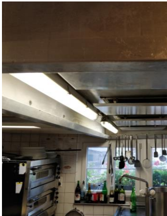
Hotte de ventilation obsolète
