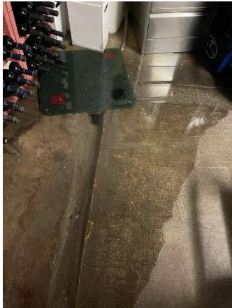
Inondations régulières de la cave
