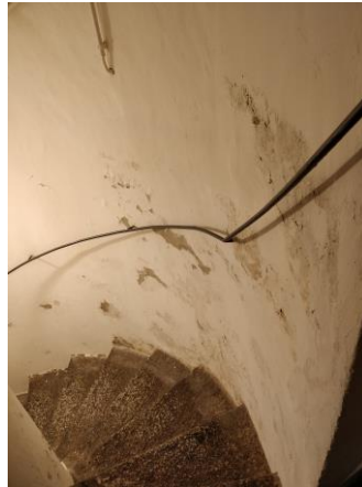
Humidité dans l'escalier de la cave
